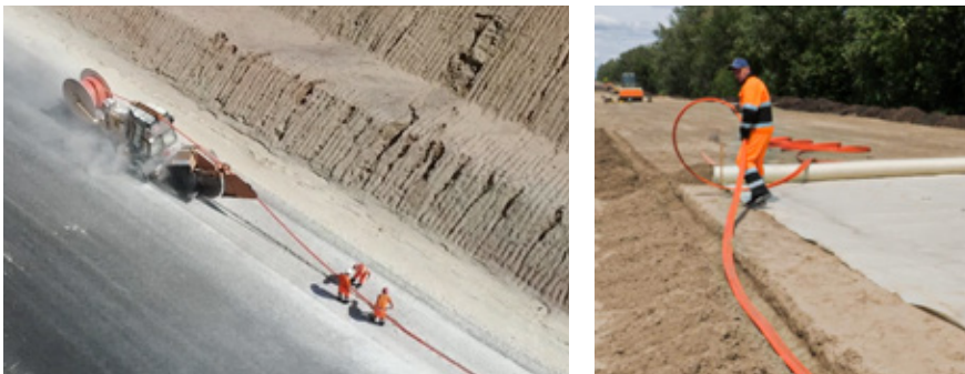
Строительство ЛКС ТМК в обочине на этапе строительства и реконструкции автомобильных дорог
